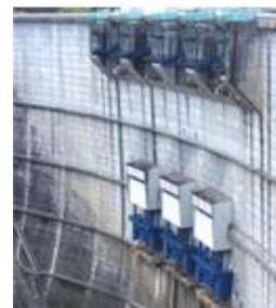
ダム堤中央の洪水吐ゲート室
